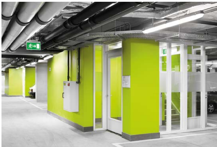
Parkeergarage en technische ruimtes
