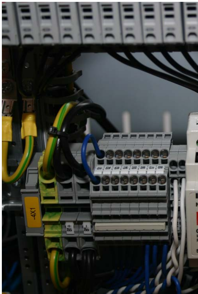
Abb.6 Anschluss 3-polige Leitung (L; N und PE) in der Unterverteilung
