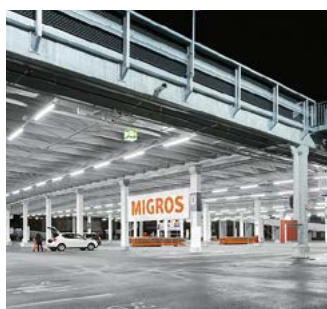
Des luminaires à pictogramme visibles de loin réduisent le nombre de luminaires nécessaires.
