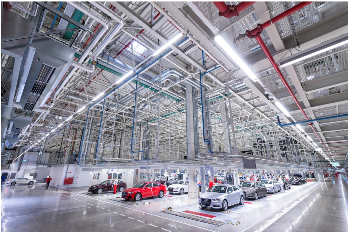
Image 2 : Dans les halles de montage, plus de 140 kilomètres du système de chemin lumineux TECTON ont été installés.
