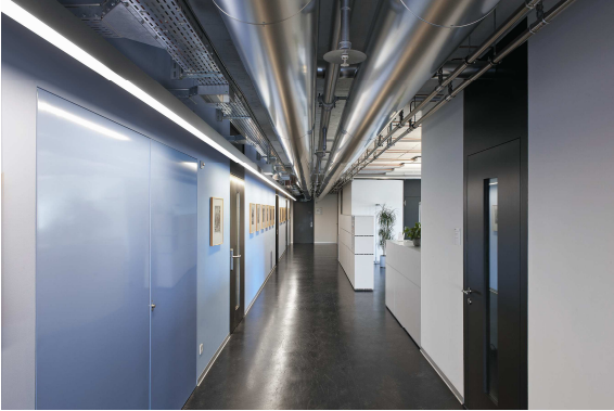
Foto 2: Il primo dei due corridoi è rimasto immutato; nel secondo corridoio sono stati montati invece innovativi apparecchi LED Slotlight LED di Zumtobel.
