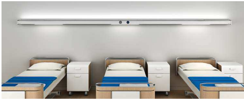
Image 3: Chambre à trois lits avec chemin lumineux à LED continu (éclairage ambiant) et des modules d'éclairage à LED (éclairage de lecture / d'examen).
