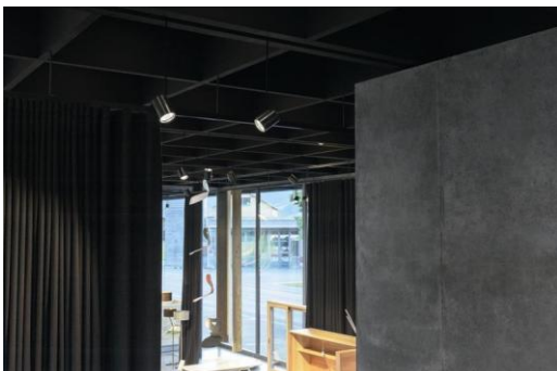
Photo 4: Dans cet espace, grâce à un système de suspension spécial, Zumtobel a placé environ 160 spots LED de la série Panos Infinity. Les projecteurs sont montés sur des rails Tecton.
