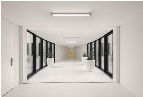
Foto 5: Nei corridoi e nei locali di servizio del complesso Leica sono state installate plafoniere LINARIA allo scopo di facilitare l'orientamento.
